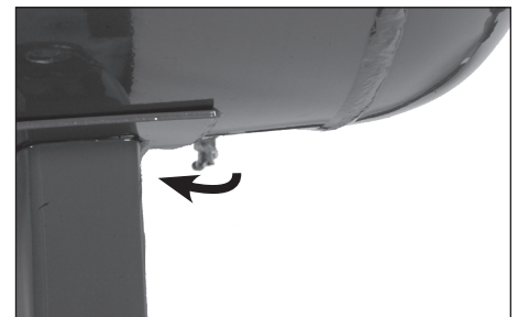
Figure 16 - Drain de réservoir manuel
